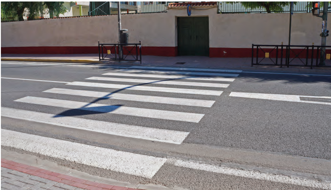
Estado actual del paso de cebra situado junto al colegio "Divino Maestro" tras su repintado.
